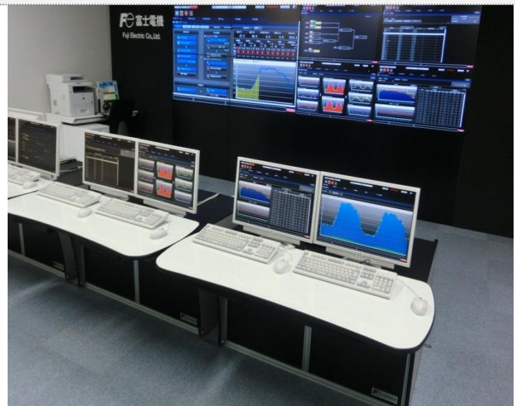
【Source】 Kitakyushu Verification Project (Fuji Electric Co., Ltd.)
